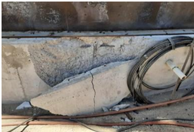
Figura 32. Delaminación del concreto de recubrimiento en el radial 114° del anillo de cimentación (1ra falla – 4 anillos)
