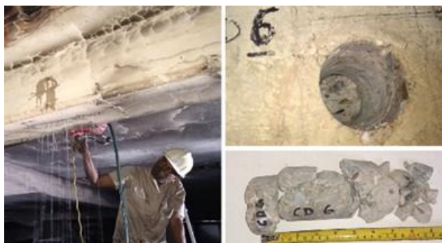
Figura 46. Núcleos de concreto indican la alta disgregación interna, no apreciable en superficie
