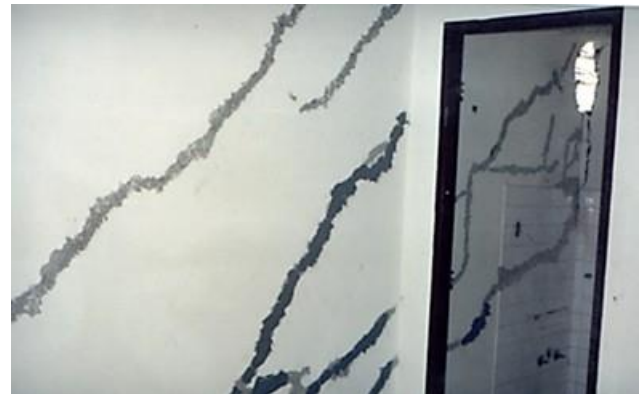
Figura 79. Tipología de agrietamientos a 45° en pantallas
