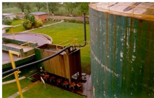
Figura 51. Ambiente externo del Tanque Digestor
