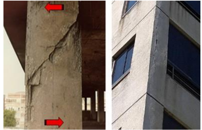
Figura 7. Izquierda: grieta por corte en columna (incendio); derecha: grietas longitudinales en esquina (corrosión)
