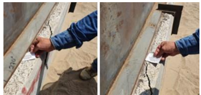
Figura 34. Izq. Placa anular separada del concreto base en el perímetro de la falla. Der. Placa anular en contacto pleno con el concreto en el eje de falla
