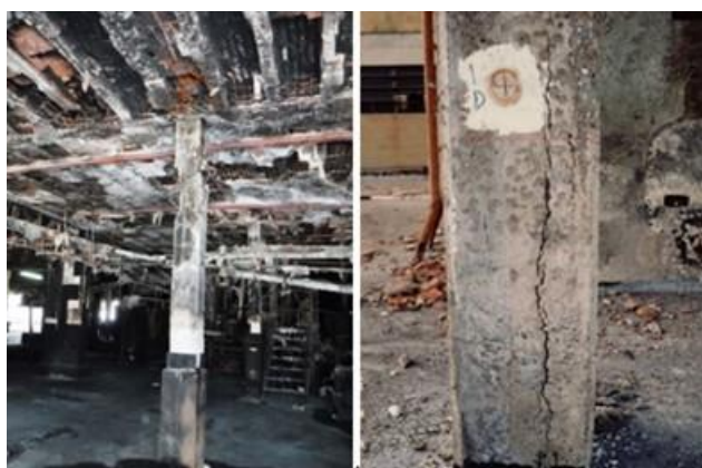
Figura 24. Daños severos en estructuras de concreto reforzado. Izquierda: colapso de columna por degradación del concreto. Derecha: agrietamiento de aristas, degradación, cambio de color
