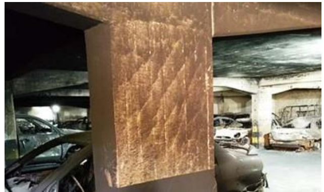
Figura 44. Daños indirectos: grietas por cortante en columnas
