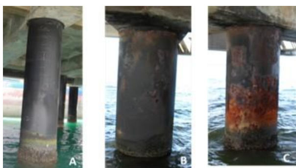
Figura 71. Pilotes del puente de acceso, mostrando la clasificación de daños, de acuerdo con el área afectada por la corrosión: A: buen estado; B: corrosión leve; C: estado crítico
