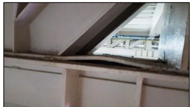
Figura 42: Alabeo en viga metálica
