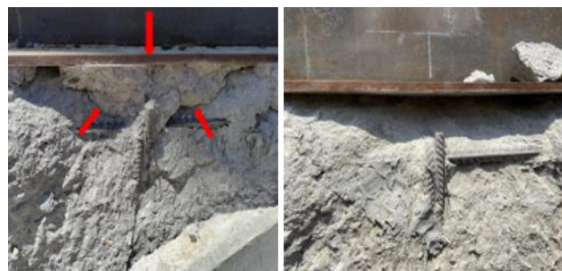
Figura 36. Izq. Detalle del cono de falla primario. Der. Vacío remanente luego de retirar el concreto fracturado del cono
