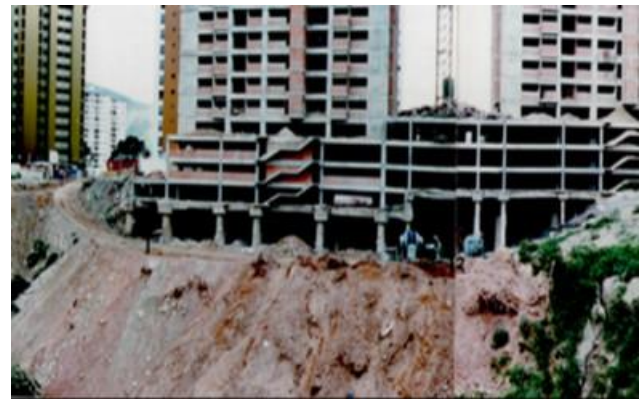
Figura 15. Movimiento de masas que dejó al descubierto las cimentaciones
