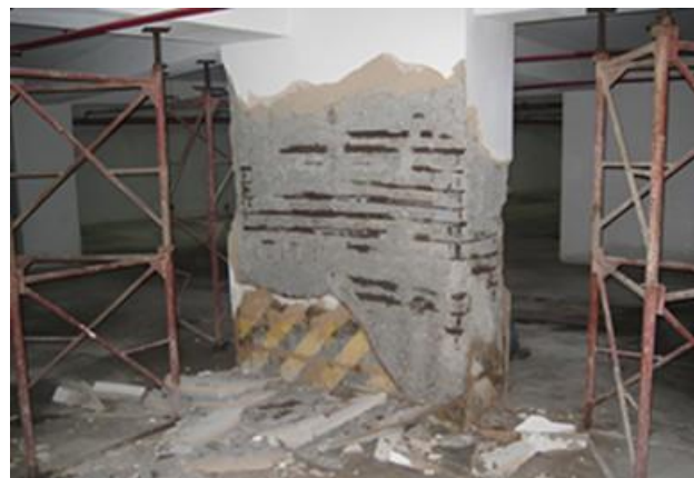
Figura 12. Daño severo en columna a causa de la corrosión
