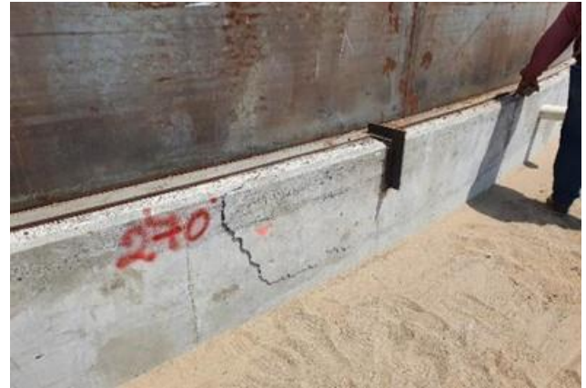
Figura 33. 2da falla del concreto con 5 anillos instalados
