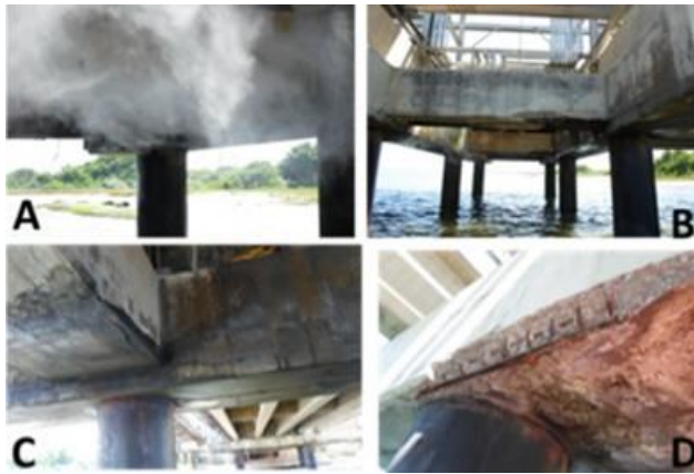
Figura 69. A: Zona afectada por el vapor de agua, lado oeste; B: Vista cercana de la viga de conexión y el cabezal afectado por grietas y corrosión de la armadura; C: otra de las vigas de conexión con grietas por corrosión de la armadura y D: delaminación del concreto con corrosión severa del acero expuesto en un cabezal
