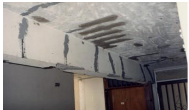
Figura 80. Tipología de agrietamientos en vigas de unión de las dos alas de la edificación
