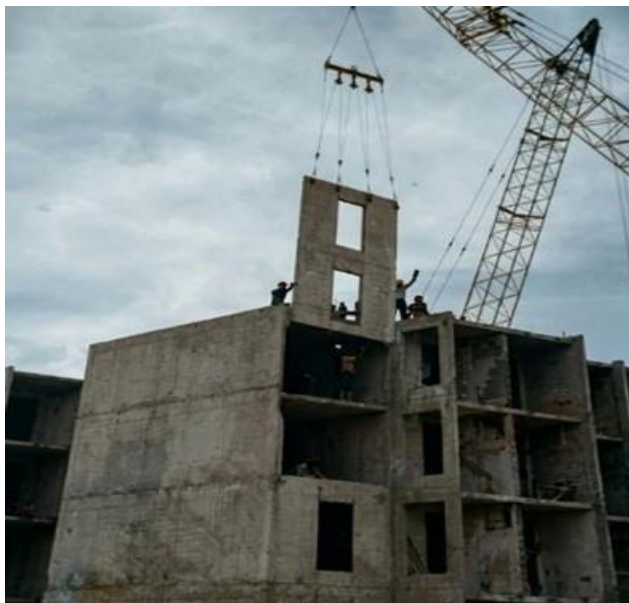
Figura 89. Ensamble de paneles prefabricados. Detalle de juntas sin tratamiento adecuado
