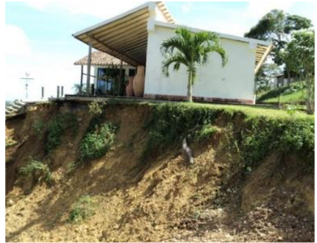
Figura 14. Edificación en peligro de colapso por la omisión en la identificación de suelos dispersivos
