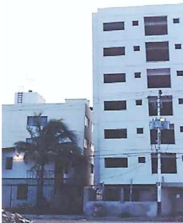
Figura 17. Asentamiento e inclinación de una edificación cimentada en una losa apoyada sobre suelos blandos
