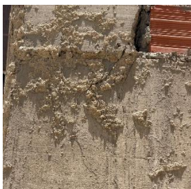
Figura 8.23. Agrietamiento diagonal de nodo. Edificio en Guatire. Foto: J. Morales.
