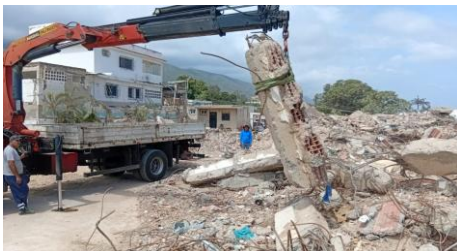
Figura 19.1. Recuperación de elementos en zona de colapso.
