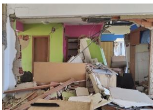
Figura 8.34. Colapso de paredes de mampostería en vivienda. Edif. Costa Bella, Caraballeda. Foto: D. Pizarro y F. Rojas).
