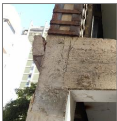
Figura 8.18. Grieta por flexión en viga. Edif. Pas-Mar. Los Palos Grandes. Foto: A. Marinilli.
