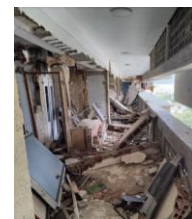
Figura 8.35. Colapso de paredes de mampostería en pasillo. Edif. Costa Bella, Caraballeda Foto: D. Pizarro y F. Rojas.
