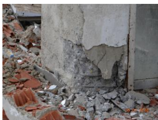
Figura 8.10. Rótula plástica en base de columna. Edif. OPPPE 30, Caraballeda. Foto: N. Fernández.
