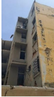
b) Corrosión en muros de concreto
