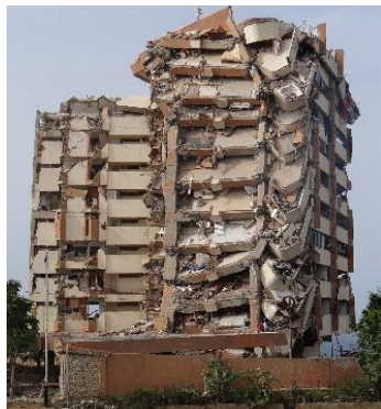
Figura 8.2. Colapso parcial. Edificio El Jurel, Catía La Mar. Foto: N. Fernández.
