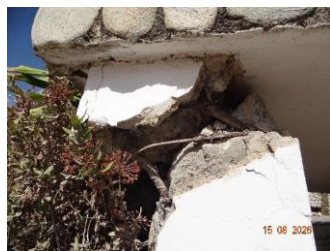
Figura 8.13. Falla por corte de columna. Edificio Coral Park, Caraballeda. Foto: N. Fernández.
