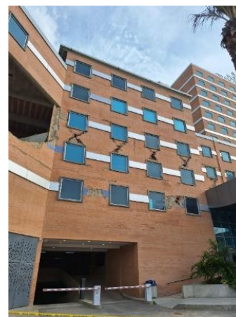
Figura 15.10. Daños en el hotel del aeropuerto. Fotos: M. Lafuente.
