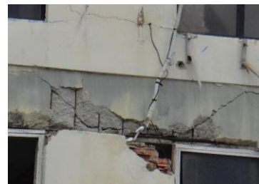
Figura 8.22. Agrietamiento por corte en viga. Edificio Punta Brisa, Macuto. Foto: N. Fernández.
