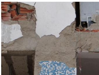
Figura 8.21. Agrietamiento por corte en vigas. Edificio OPPPE 30, Caraballeda. Foto: N. Fernández.
