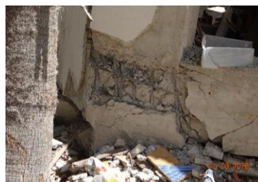
Figura 8.26. Falla de nodo. Edificio Vista Mar, Caraballeda. Foto: N. Fernández.
