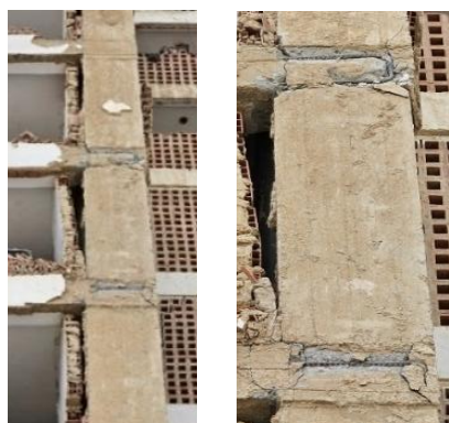
Figura 11.10. Anclaje deficiente de barras de vigas en juntas. OPPPE 26. Foto: L. Hernández.
