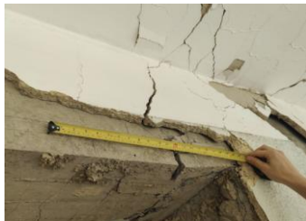
Figura 8.19. Rótula plástica en viga. Edificio Costa Bella, Caraballeda. Foto: D. Pizarro y F. Rojas.
