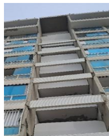
c) Detalle de dintel, detallado deficiente
