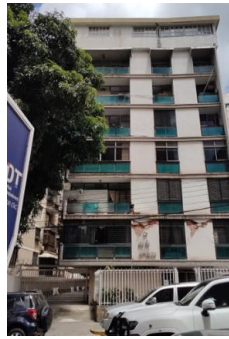
Figura 8.30. Daños en paredes de mampostería. Edificio Mar de la Plata, Los Palos Grandes. Foto: A. Marinilli.
