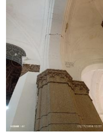
c) Daños en los arcos y bóvedas
