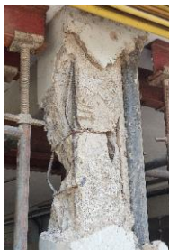
Figura 8.7. Falla por compresión de columna. Res. Manella, Bello Campo. Foto: A. Marinilli.
