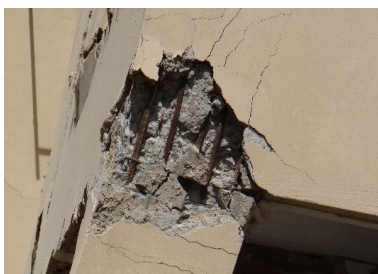
Figura 8.25. Falla de un nodo de las Residencias Mariola en Caraballeda (fotografía N. Fernández).
