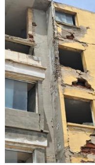
c) Corrosión de borde de fachada
