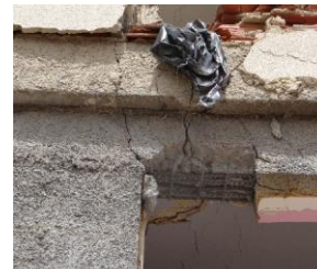
Figura 8.20. Rótula plástica en viga. Residencias Mar Caribe, Caraballeda. Foto: N. Fernández.
