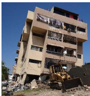
Figura 8.4. Colapso de planta baja. Residencias Mariola en Caraballeda (foto N. Fernández).
