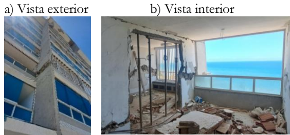
Figura 9.8. Detalle de falla en el muro del segundo nivel.
