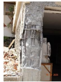
Figura 8.9. Falla por compresión de columna. Residencias Mar Caribe, Caraballeda. Foto: N. Fernández.
