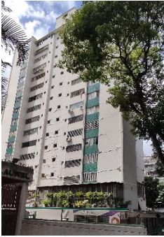
Figura 8.29. Daños en paredes de mampostería. Edificio Green Palace, Los Palos Grandes. Foto: A. Marinilli.
