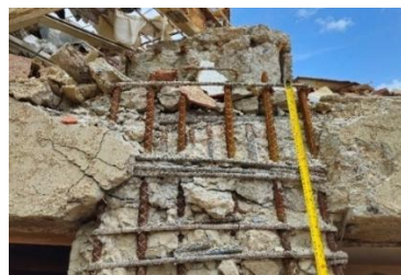
Figura 11.9. Falta de confinamiento adecuado del nodo de la OPPPE 27. Foto: L. Hernández.
