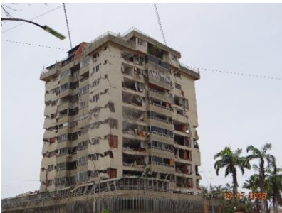
Figura 8.32. Colapso de mampostería. Edificio El Ancla, Caraballeda. Foto: N. Fernández.
