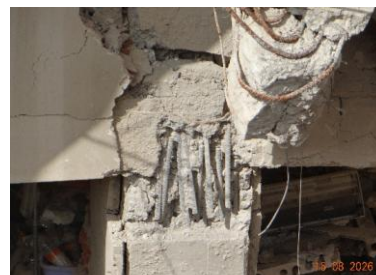
Figura 8.24. Falla de nodo. Edificio Costa Azul, Catia La Mar (Foto: N. Fernández).
