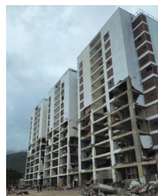
Figura 11.11. Derrumbe paredes de mampostería. OPPPE 26. Foto: L. Hernández.
