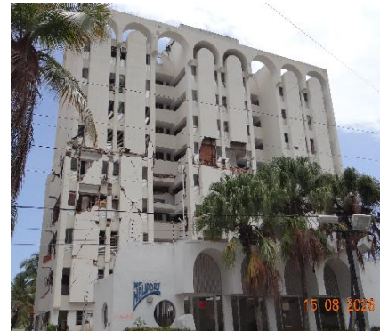
Figura 8.3. Colapso de piso intermedio. Edificio Newport, Caraballeda, Foto: N. Fernández.
