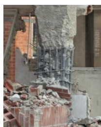
Figura 8.15. Comportamiento inadecuado de los empalmes por solape del refuerzo de una columna. Foto: M. Hube.
