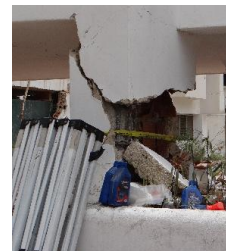
Figura 8.14. Falla por «columna corta». Edificio Newport, Caraballeda. Foto: N. Fernández.
