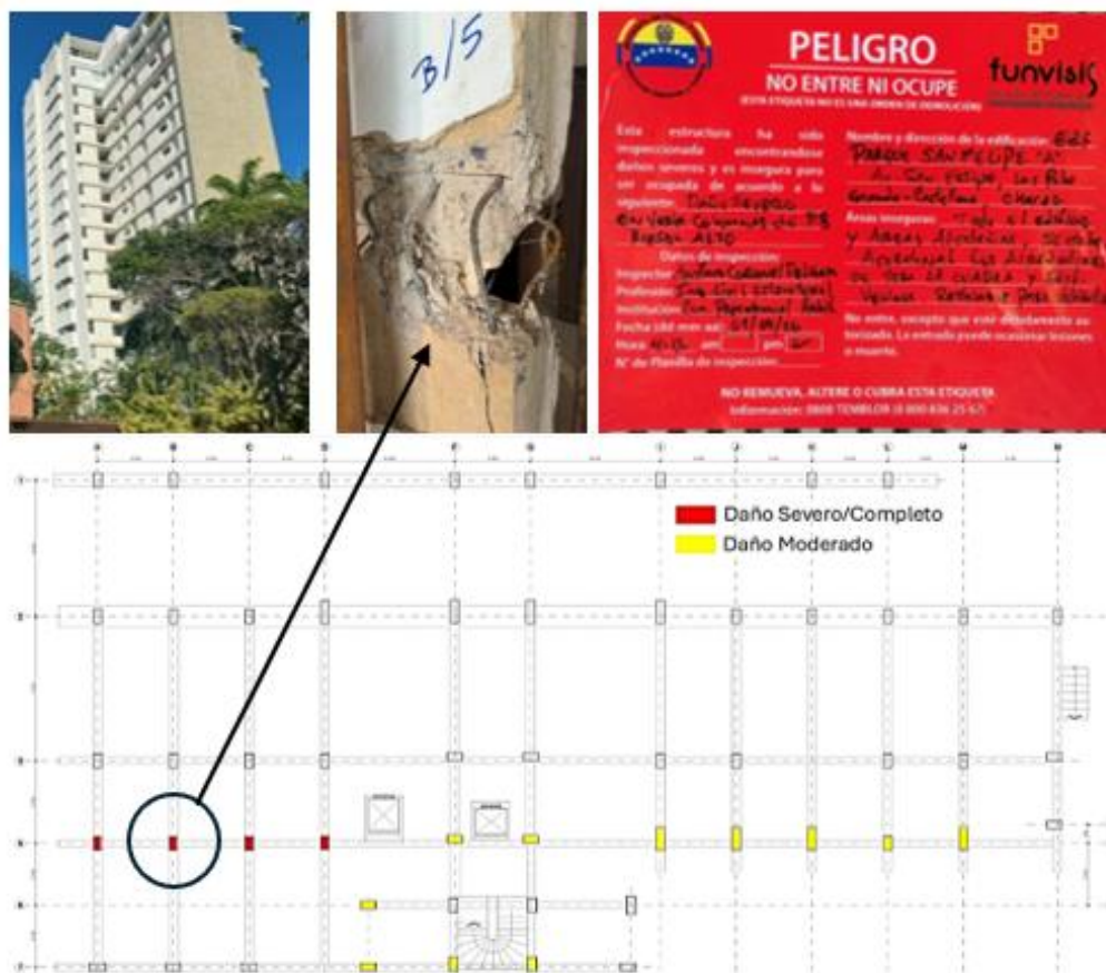
Figura 7.1. Levantamiento detallado de daños del Edificio Parque San Felipe A en Altamira. (Fotos: G. Coronel Delgado. Plano de Semi Sótano, adaptado del suministrado por los propietarios).
