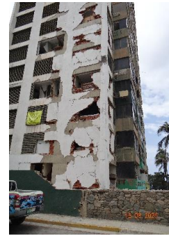
Figura 8.31. Daños en paredes de mampostería. Residencias Parque del Caribe, Macuto. Foto: N. Fernández.
