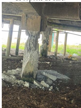
d. Detalle de daño en columna de soporte de base.
