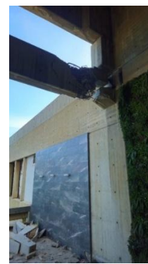
Figura 15.8. Daños en viga del terminal internacional del aeropuerto Foto: L. Hernández.
