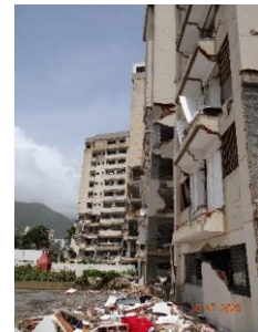
Figura 8.33. Colapso de mampostería. Residencias Mar Caribe, Caraballeda. Foto: N. Fernández.
