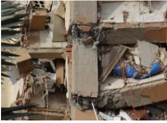
Figura 8.27. Falla de nodos. Edificio El Jurel, Catia La Mar. Foto: N. Fernández.
