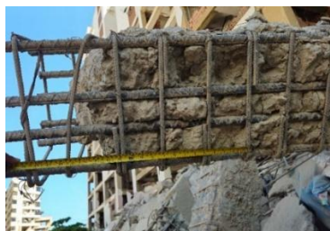
Figura 11.8. Separación adecuada de estribos en viga de la OPPPE 26, con deficiencia en el doblez de 90^\circ de los ganchos. Foto: L. Hernández.
