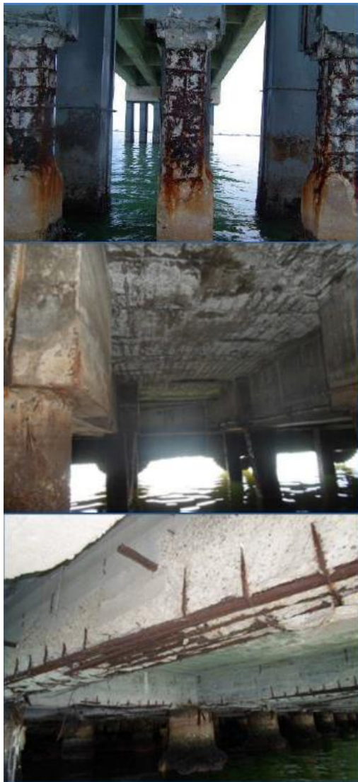
Figura 16. Daños por corrosión del acero de refuerzo en estructuras de muelles en puertos mexicanos
