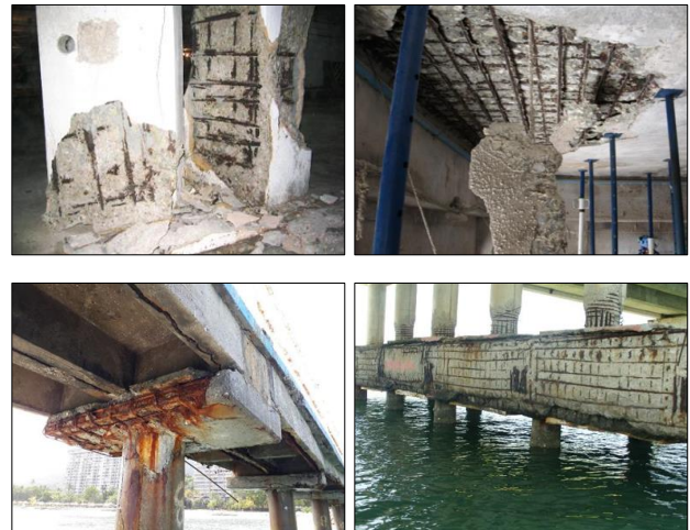
Figura 29. La realidad de las afectaciones por corrosión
