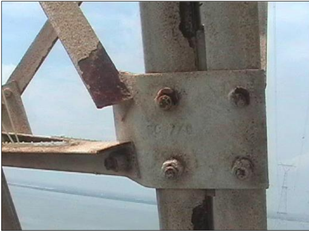
Figura 8. Daños en perfiles, placas y pernos
