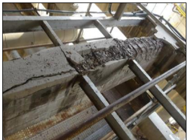
Figura 12. Vistas de daños encontrados en vigas
