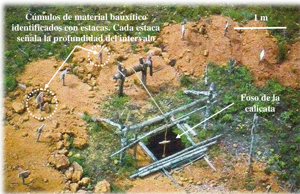
Figura 1. Al principio, hubo necesidad de hacer descender en rapel a tres trabajadores oriundos de la zona, desde el helicóptero, para abrir el helipuerto. La primera calicata en el yacimiento de Los Pijiguaos, atravesó un espesor de 16 metros de bauxita. Los cúmulos de bauxita, alrededor del foso, con señalamiento en estacas, indican un metro lineal de la calicata, usada para la toma de muestra secuencial. Foto archivo CVG Bauxiven, año 1976.
