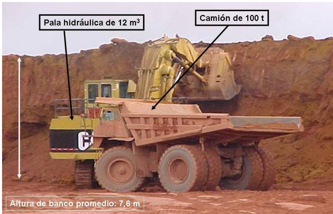
Figura 20. Operación recomendada: uso de pala hidráulica, para arranque del talud o toda la altura del frente de explotación, de una sola vez, como política de calidad y control de humedad, con el uso de camiones de 100 t, a fin de mantener productividad. GARCIA et. al. (1995). Foto: CVG BAUXILUM, año 1998.
