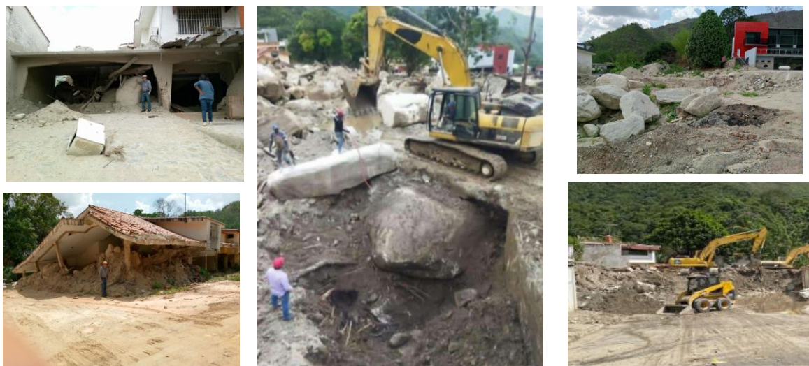
Figura 7. Impactos de los aludes torrenciales en el Castaño y trabajos de remoción de sedimentos.
