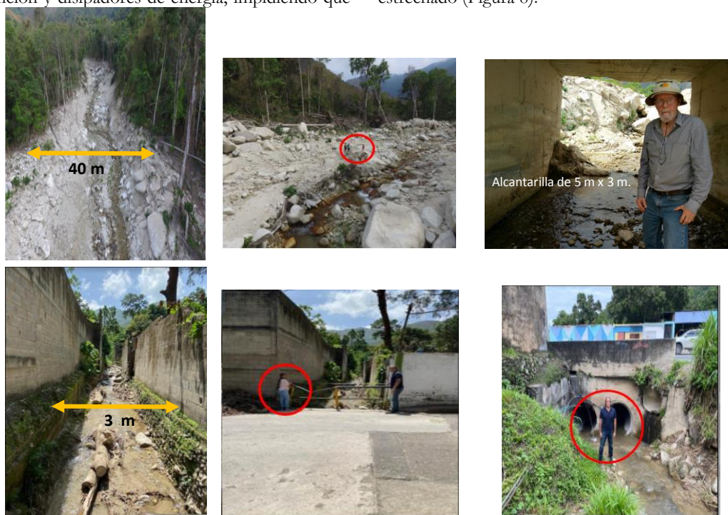
Figura 8. Secuencia de fotos mostrando las restricciones al cauce en la zona urbana. Las dos primeras fotos en la fila superior, muestran el cauce amplio en la garganta del río Palmarito, con un ancho cercano a 40 m. El resto de las fotos presentan imágenes del cauce contraído por la presión urbanística hasta anchos de 3 m. Los círculos color naranja resaltan personas como referencia de tamaño.
