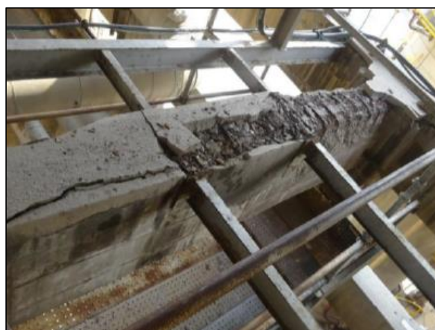
Figura 12. Vistas de daños encontrados en vigas
