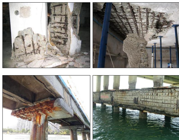
Figura 29. La realidad de las afectaciones por corrosión
