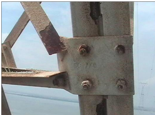
Figura 8. Daños en perfiles, placas y pernos
